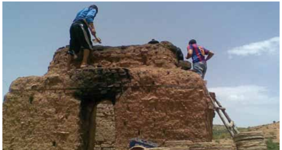
Destruction du four traditionnel (crédit photo PNUD)
